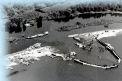
Fotografie aeriană despre lucrările de corectare a rupturii de pe terasament
