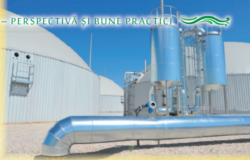
Instalație pentru curățarea gazelor ce funcționează cu ajutorul cărbunelui activ
